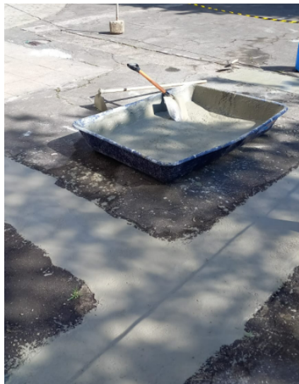
FOTO 87: Fechamento dos vãos de abertura do piso da área externa, realizada pelos ocupantes anteriores ao CG.
