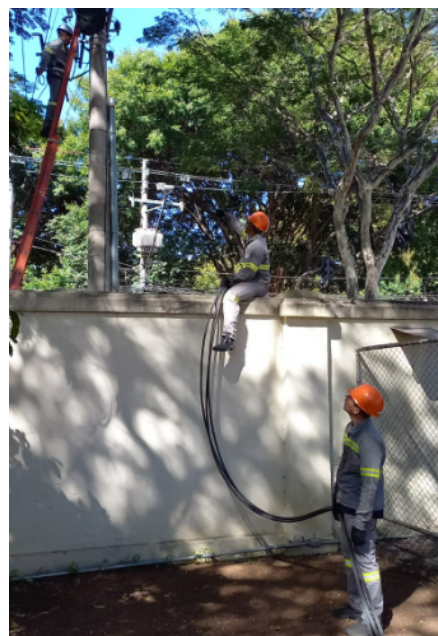
FOTO 10: Diagnóstico: Manutenção corretiva cabine primária, substituição do ramal de entrada, revisão dos condutores e elementos de condução.
