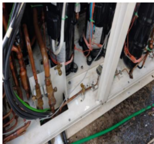
FOTO 26: Atividade para ativação do sistema de climatização, correção do circuito frigorígeno, teste de estanqueidade da linha de condução.
