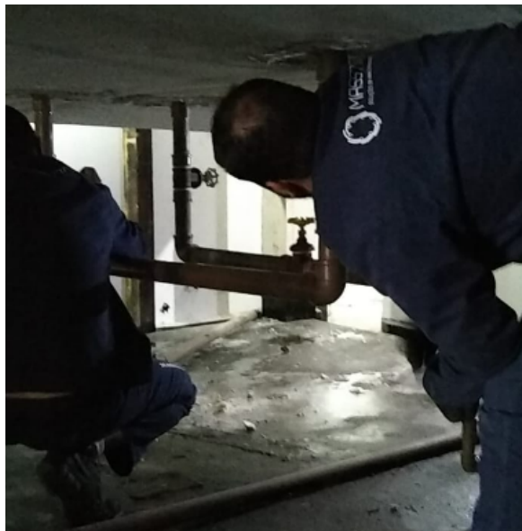
FOTO 11: Adequação do barrilhete hidráulico de água potável superior para abastecimento de água nos sanitários.
