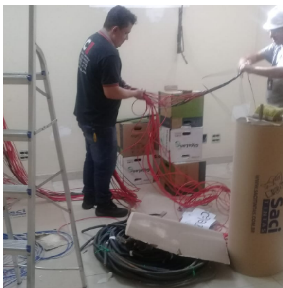
FOTO 69: Implantação de estrutura de cabeamento estruturado do pavimento inferior, chegada sala futuro CPD.
