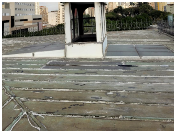
FOTO 77: Isolamento emergencial da cobertura, devido aos pontos de infiltração, localizado nas salas de máquina dos elevadores.
