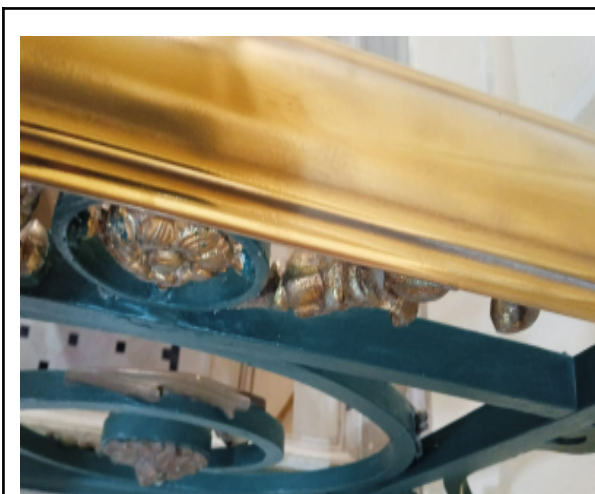
FOTO 95: Conservação do corrimão escadaria central.
