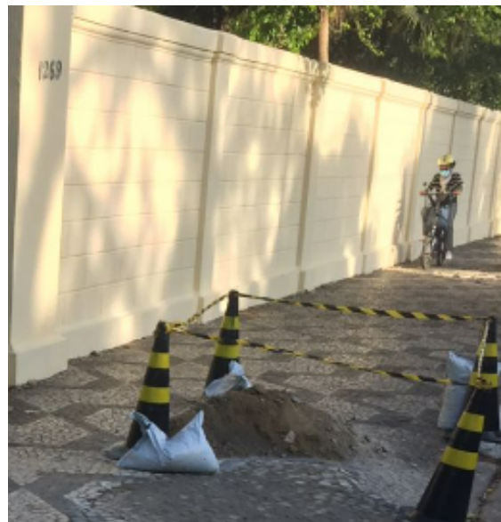
FOTO 20: Conservação revestimento da calçada frontal da Avenida Rio Branco, isolamento parcial para cura.
