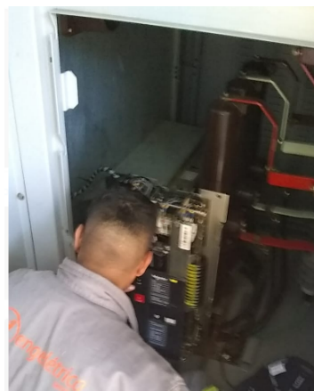
FOTO 4: Atividade de manutenção corretiva do ramal de entrada de média tensão, entrada dos condutores para TPS e TCS, disjuntor de média tensão.
