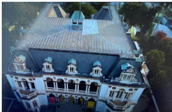
FOTO 75: Isolamento emergencial da cobertura, devido aos pontos de infiltração.
