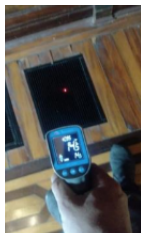
FOTO 34: Ativação do sistema de climatização, teste operacional dos equipamentos com insuflamento inferior, adequação vazão de retorno e insuflamento.
