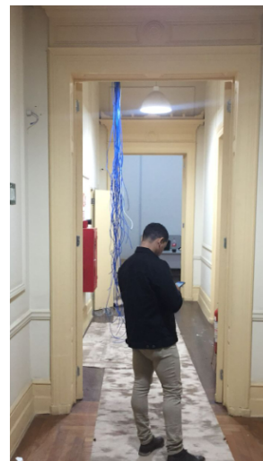
FOTO 82: Implantação de estrutura de rede Wireless no primeiro pavimento, salas de trabalho.
