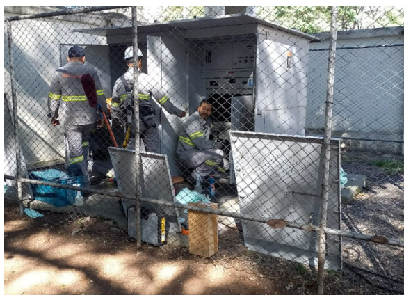
FOTO 7: Diagnóstico: Atividade de manutenção corretiva cabine primária pela equipe de conservação elétrica, medição dos componentes.
