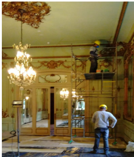
FOTO 67: Conservação do forro da sala multiuso central, correção das aberturas do forro.
