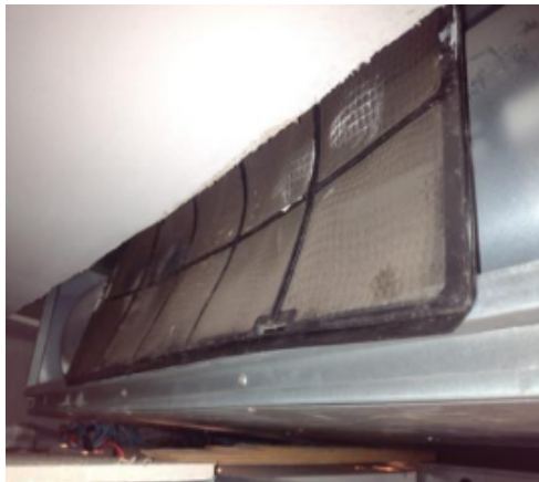
FOTO 27: Higieneização dos equipamentos de climatização.
