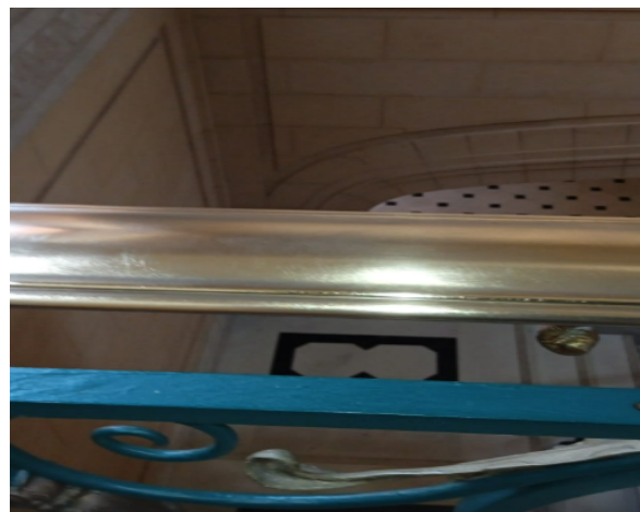
FOTO 96: Conservação do corrimão escadaria central.
