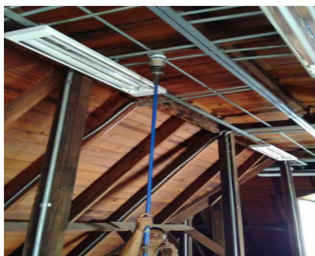
FOTO 38: Conservação sistema de prevenção e combate ao incêndio.
