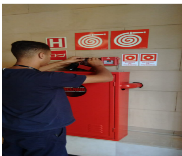
FOTO 37: Conservação sistema de prevenção e combate ao incêndio.
