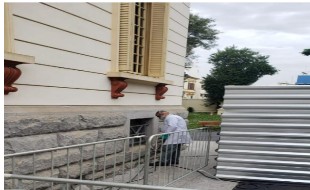
FOTO 79: Execução de barreira química anual preventiva para tratamento de cupins de solo.
