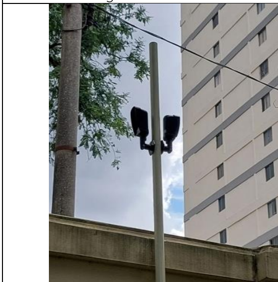
FOTO 79: Implantação de sistema de barreira eletrônica para monitoramento do perímetro.
