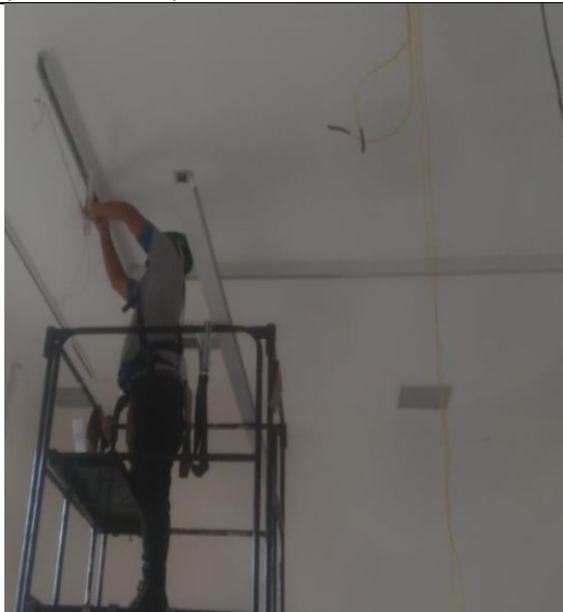
FOTO 63: Instalação de iluminação das salas expositivas do primeiro andar.
