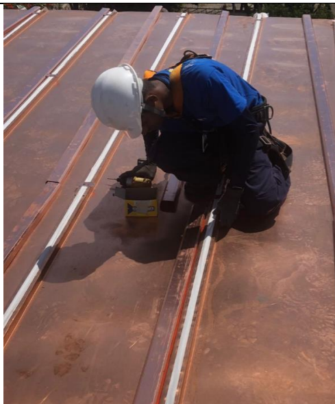
FOTO 129: Conservação cobertura, aplicação de novas telhas e acabamento dos caibros em cobre.
