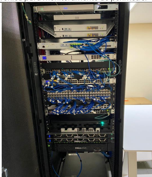
FOTO 83: Implantação rack de distribuição para CFTV e rede wireless.
