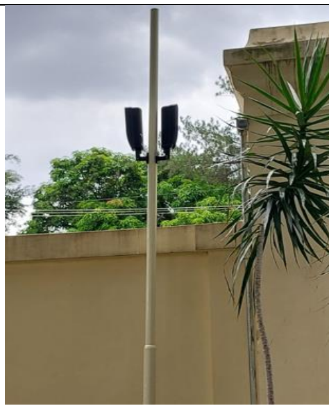
FOTO 82: Implantação de sistema de barreira eletrônica para monitoramento do perímetro.
