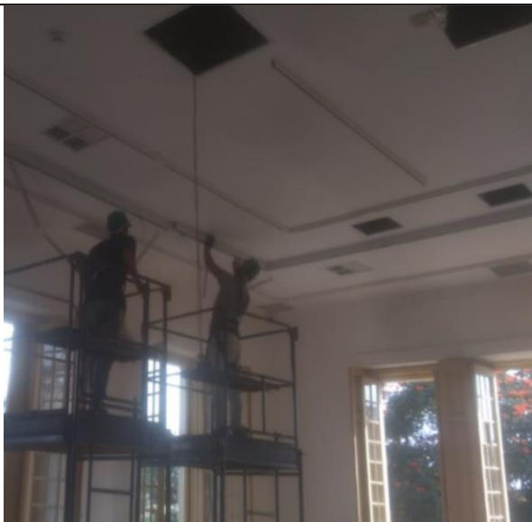
FOTO 69: Instalação de iluminação das salas expositivas do primeiro andar.
