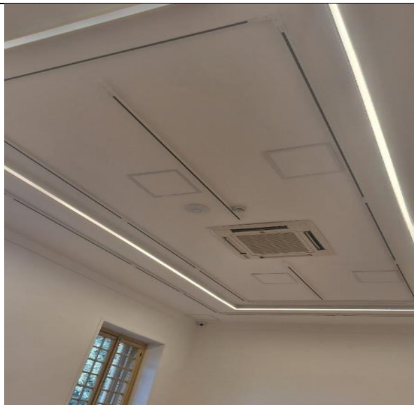
FOTO 70: Instalação de iluminação das salas expositivas do primeiro andar.
