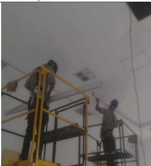
FOTO 67: Instalação de iluminação das salas expositivas do primeiro andar.
