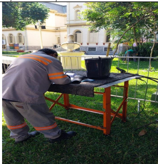
FOTO 75: Manutenção anual periódica dos equipamentos de proteção individual e coletiva da entrada de energia elétrica.
