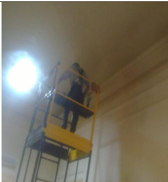
FOTO 73: Instalação de iluminação das salas expositivas do primeiro andar.
