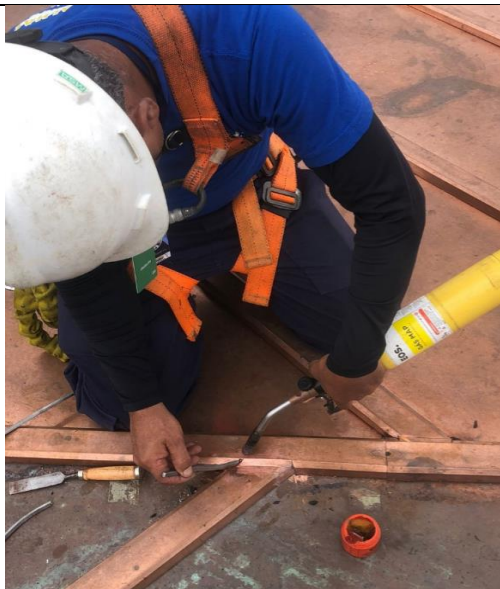
FOTO 130: Conservação cobertura, aplicação de novas telhas e acabamento dos caibros em cobre.
