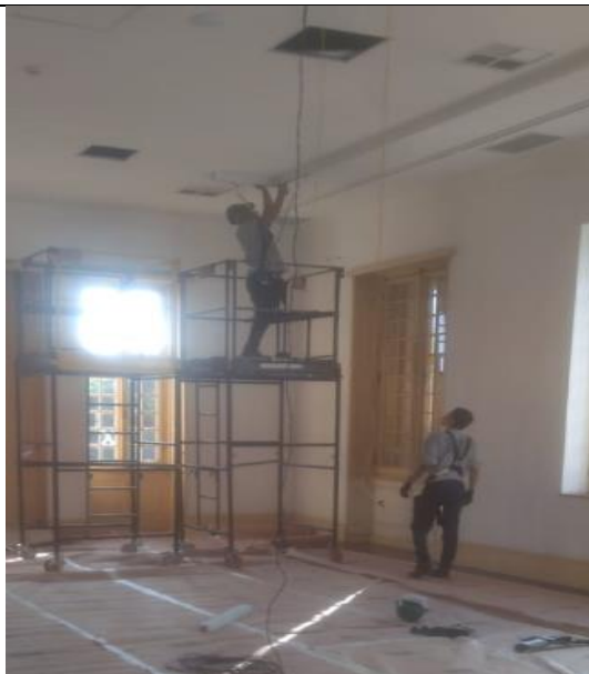
FOTO 65: Instalação de iluminação das salas expositivas do primeiro andar.
