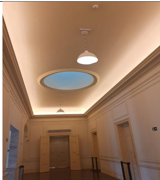
FOTO 74: Instalação de iluminação das salas expositivas do primeiro andar.
