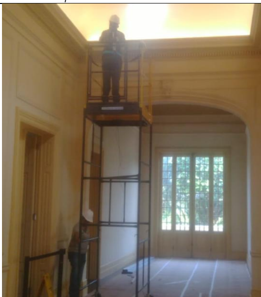
FOTO 71: Instalação de iluminação das salas expositivas do primeiro andar.
