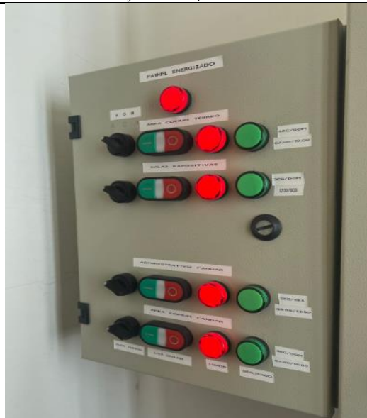
FOTO 60: Instalação de iluminação das salas expositivas do primeiro andar.
