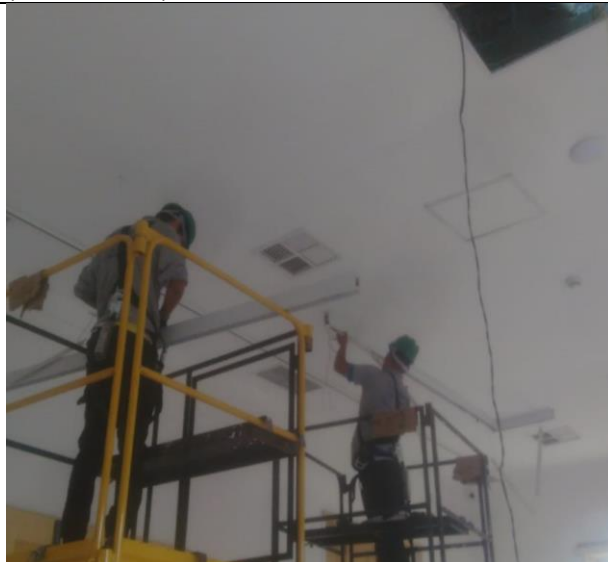
FOTO 64: Instalação de iluminação das salas expositivas do primeiro andar.
