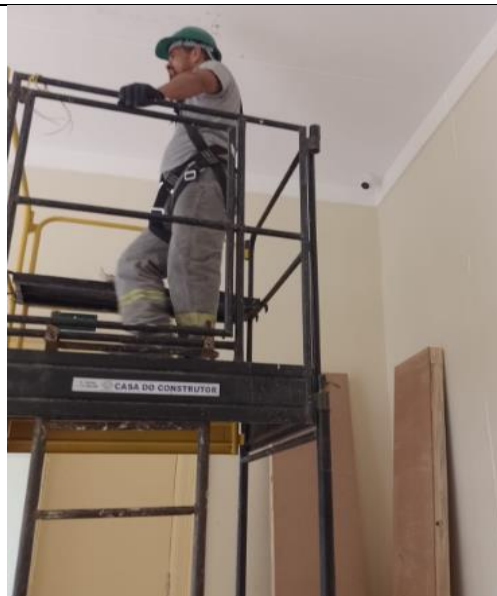
FOTO 62: Instalação de iluminação das salas expositivas do primeiro andar.
