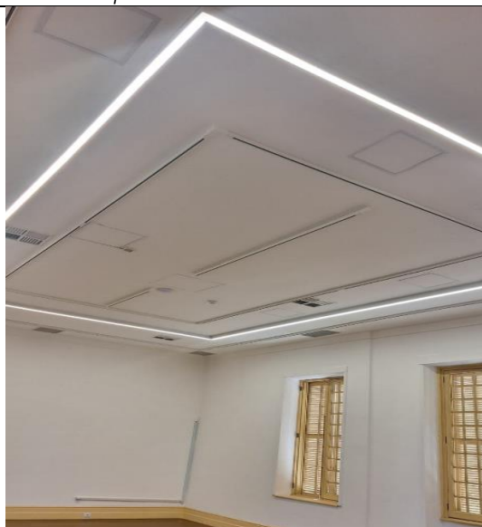
FOTO 68: Instalação de iluminação das salas expositivas do primeiro andar.
