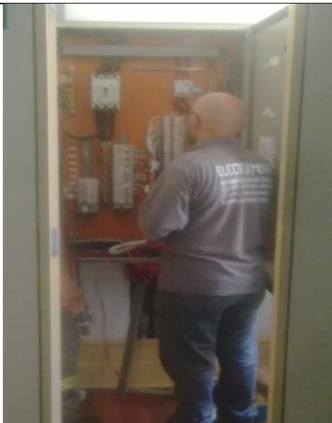
FOTO 61: Instalação de iluminação das salas expositivas do primeiro andar.
