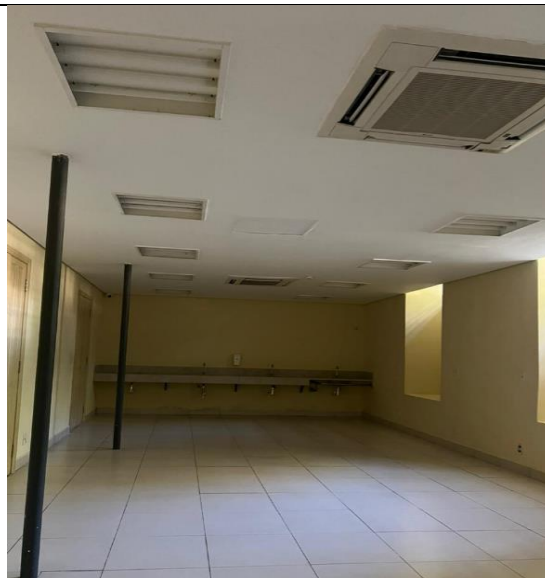
FOTO 50: Conservação do forro da sala das pias do pavimento inferior, refazimento do forro de drywall.
