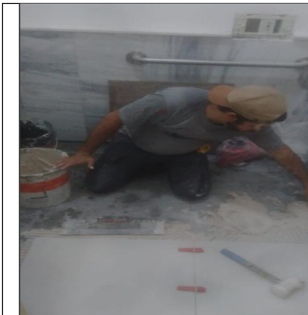
FOTO 45: Manutenção corretiva do sistema hidráulico dos banheiros do primeiro pavimento, correção de infiltração do piso.
