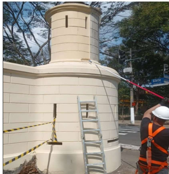
FOTO 16: Conservação muros perimetrais, esquina, Al Gleite X Rua Guaianazes.
