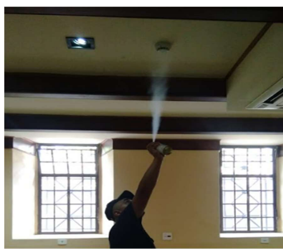
FOTO 78: Conservação equipamentos / sistema combate ao incêndio.
