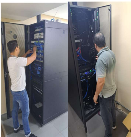
FOTO 95: Implantação CPD, rack de ativos de rede.
