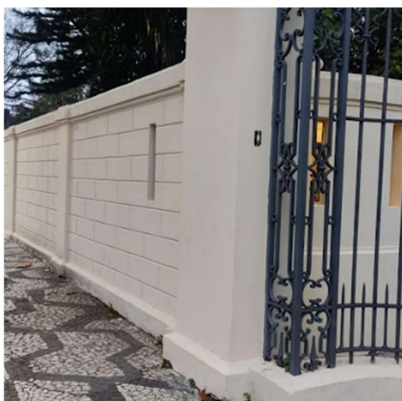
FOTO 21: Conservação muro Av Rio Branco.
