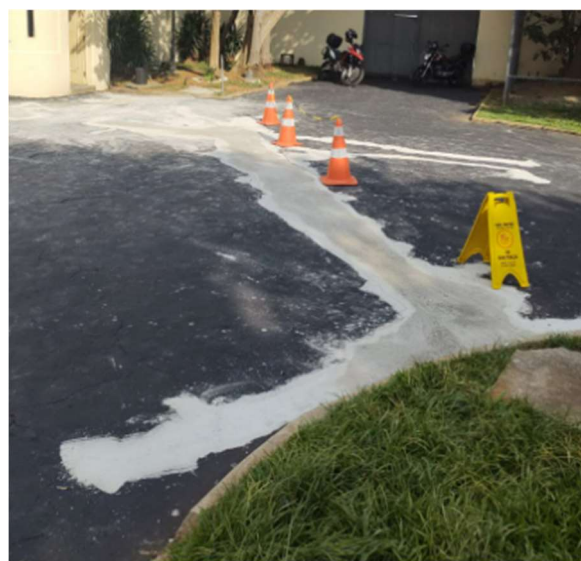
FOTO 100: Conservação revestimento externo de circulação, revestimento com elemento de demarcação, pintura e correção viária.
