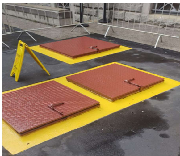
FOTO 77: Conservação equipamentos / sistema combate ao incêndio.
