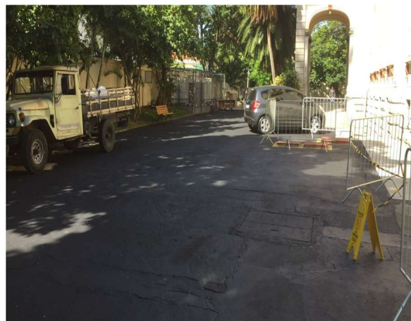
FOTO 106: Conservação revestimento externo de circulação, revestimento com elemento de demarcação, pintura e correção viária.
