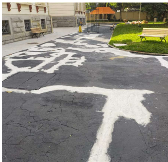
FOTO 99: Conservação revestimento externo de circulação, revestimento com elemento de demarcação, pintura e correção viária.
