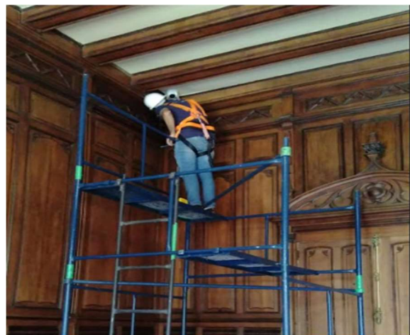
FOTO 70: Implantação CFTV, instalação nos pontos com acessos pré existentes, sala lareira, futura loja.
