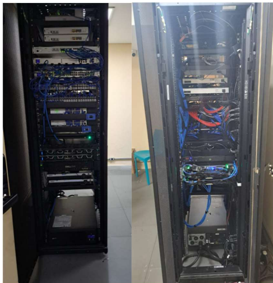
FOTO 97: Implantação CPD, rack de ativos de rede.
