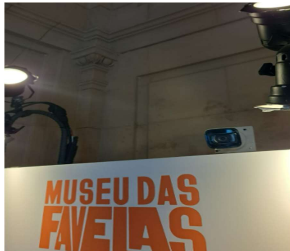
FOTO 76: Implantação CFTV, instalação nos pontos com acessos pré existentes, recepção.
