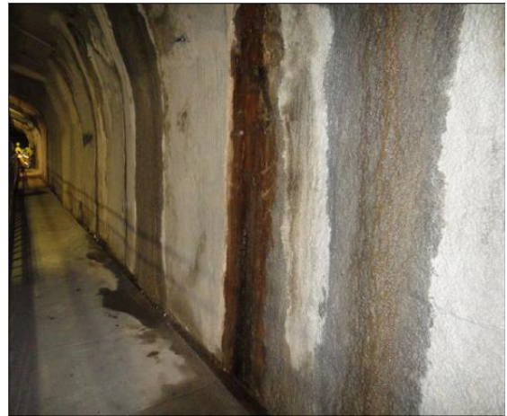
Foto 02 – Surgência nas paredes
