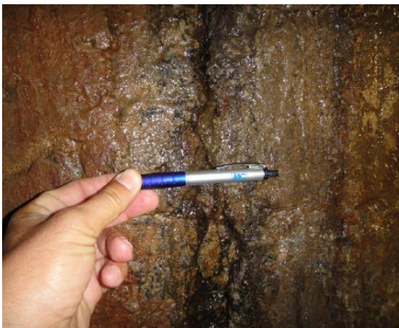
Foto 03 – Fissura com perda de substrato
