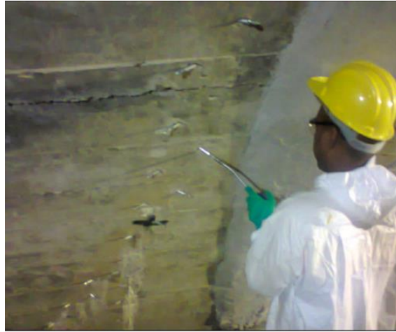
Foto 05 – Injeção de Espuma e Gel de Poliuretano MC Injekt 2033 e MC Injekt 2300 NV
