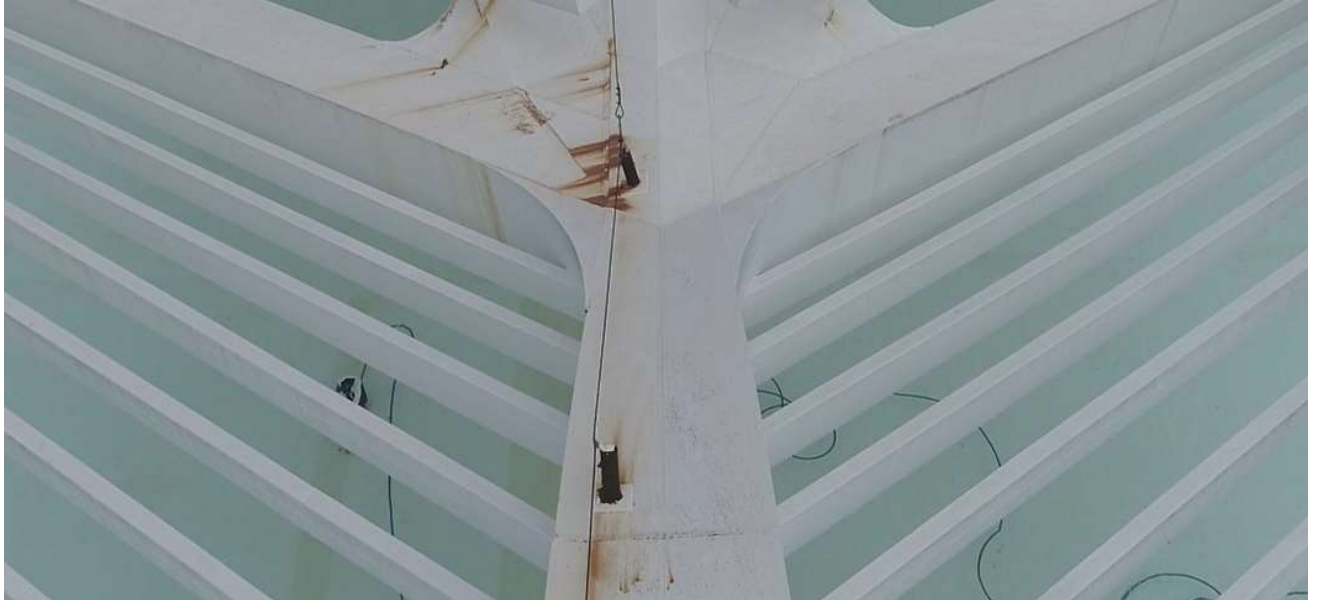
FOTO 55 – CORROSÃO ACENTUADA SUPORTE DE LINHA DE VIDA
