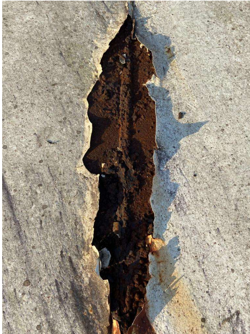
FOTO 70 – DETALHE CORROSÃO NA SOLDA DE LIGAÇÃO
