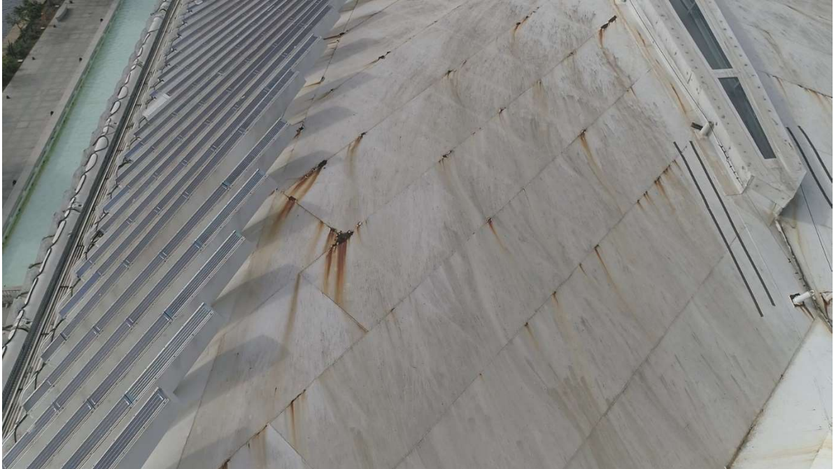
FOTO 57 – CORROSÃO GENERALIZADA NAS SOLDAS ENTRE CHAPAS DE COBERTURA
