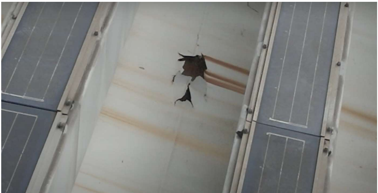
FOTO 58 – CORROSÃO COM DESCOLAMENTO DA CAMADA DE PINTURA
