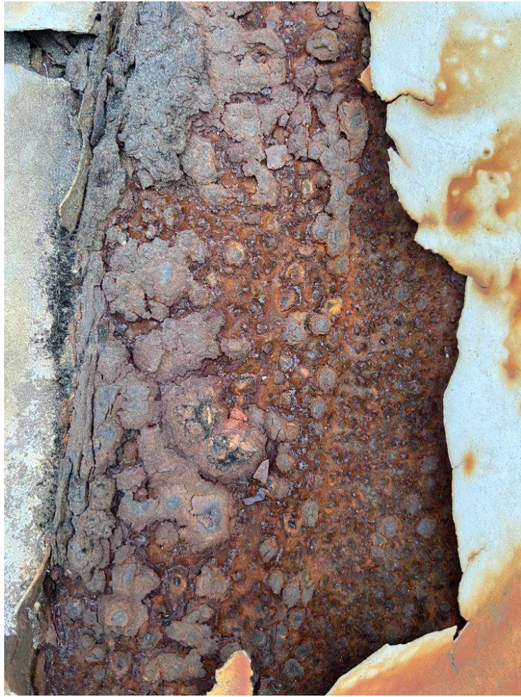
FOTO 75 – DETALHE CORROSÃO NA SOLDA ENTRE CHAPAS DE COBERTURA
