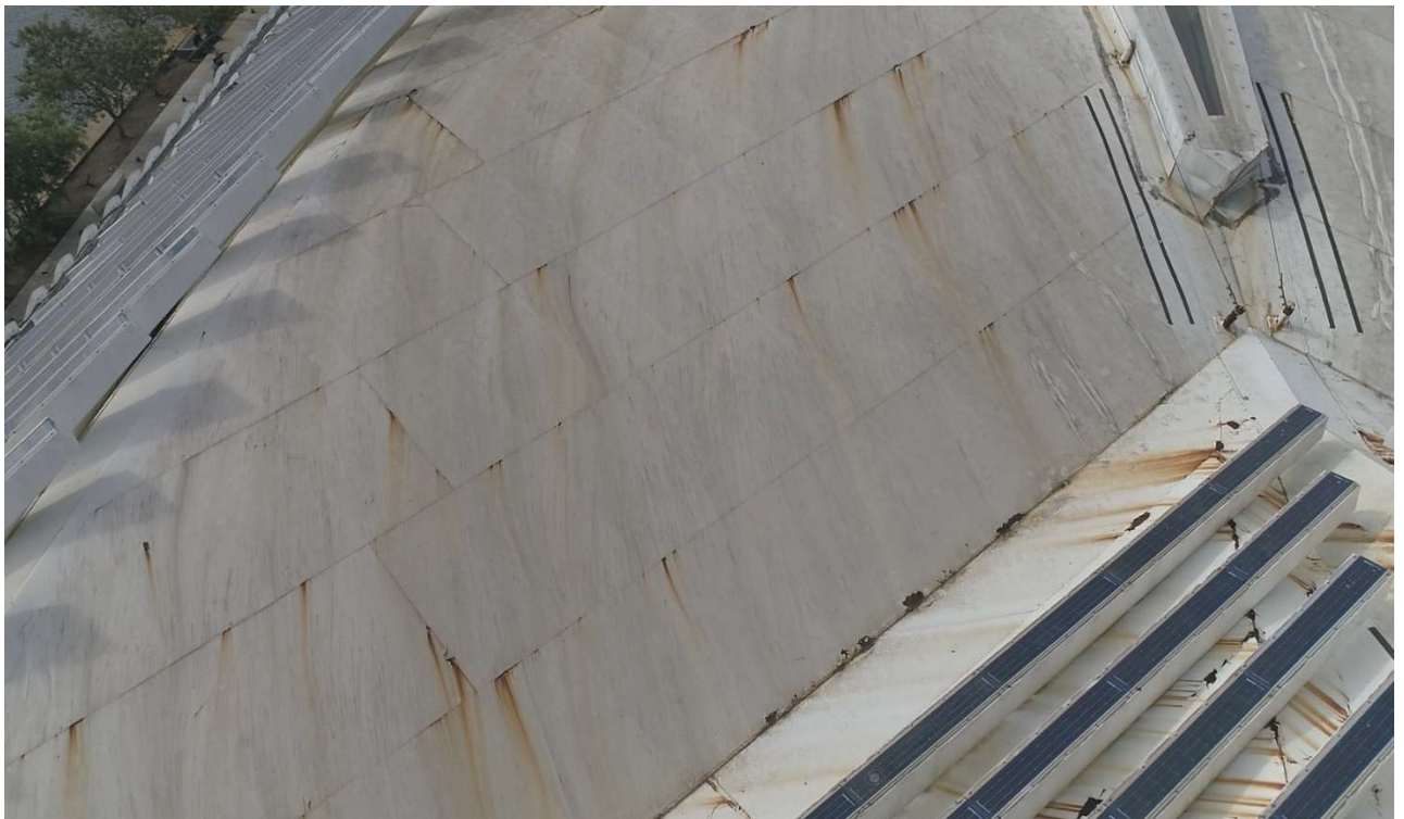
FOTO 56 – CORROSÃO GENERALIZADA NAS SOLDAS ENTRE CHAPAS DE COBERTURA
