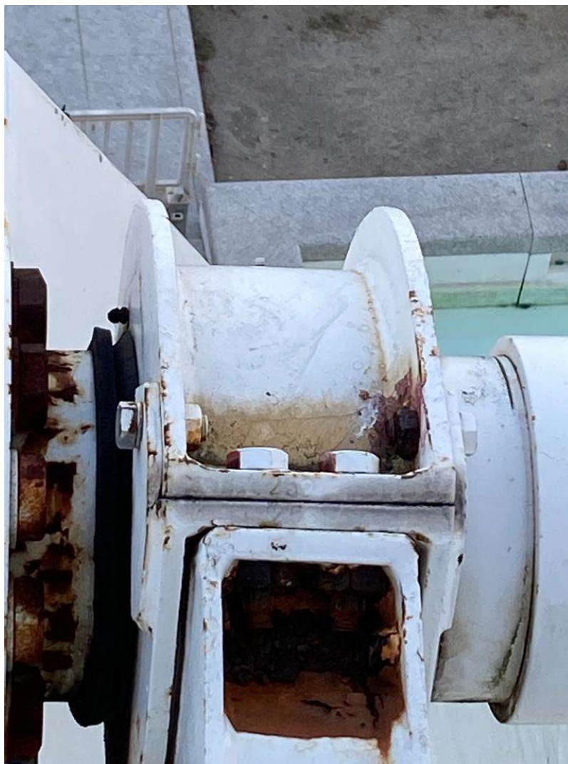
FOTO 69 – DETALHE CORROSÃO NA LIGAÇÃO DOS MANCAIS
