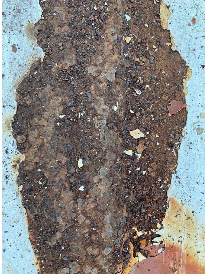
FOTO 74 – DETALHE CORROSÃO NA SOLDA ENTRE CHAPAS DE COBERTURA
